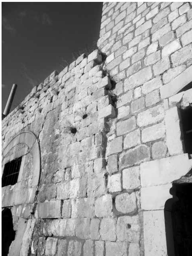
14. Ljetnikovac Bettera, prekid u strukturi зида između pročelja orsana i ladanjske kuće (foto: A. Baće) / Villa Bettera, a breach in the wall structure between the boathouse front and the villa
