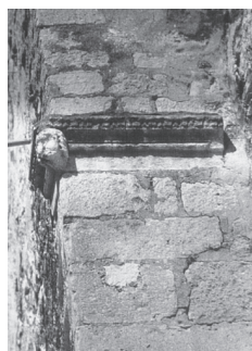
SL 76. Ukras na uglu zida samostanskog dvorišta (13A), nedavno oštećen
