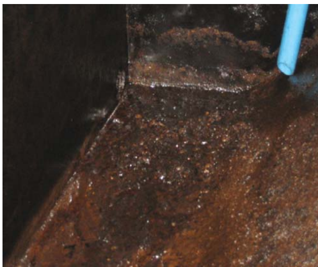
Slika 9. Rupičasta pitting korozija unutar tanka za gorivo
