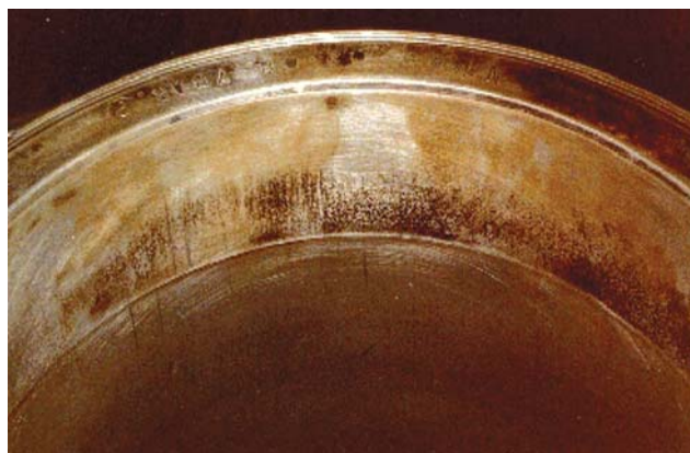
Slika 2. Niskotemperaturna korozija na gornjem dijelu košuljice
