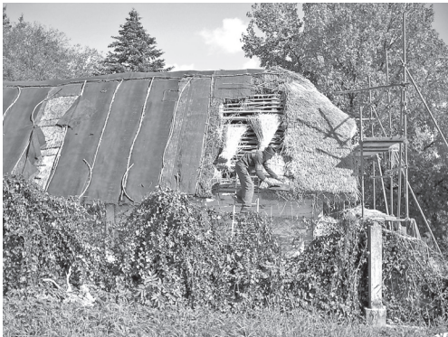
Umetanje "ritkov" na zapadnoj strani krovišta kuće i detalj krova sa starom zaštitom od nekoliko slojeva trošne ljepenke koja je štitila tradicijsku kuću
