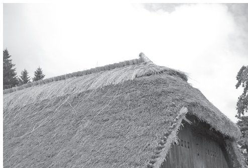
Pogled s jugozapadne strane kuće na obnovljeno sedlo i na detalj "purana" koji strži s obzirom na horizontalno pričvršćene glave u pravilnom nizu i visini
