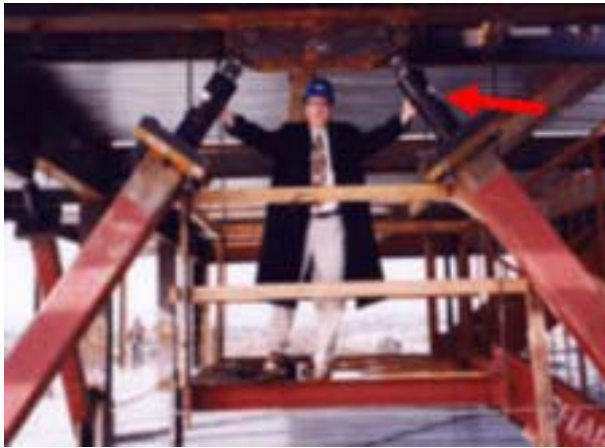
Slika 4. Histerezni prigušivač ugrađen u konstrukciju
