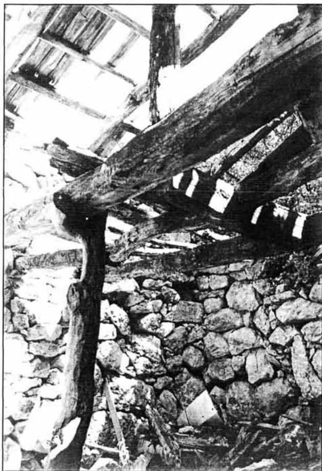
Sl. 10. Zanimljiva konstrukcija krovišta ruševine stare kovačnice u Starčević Podu, snimila Helena Knifić Schaps, svibanj 2002.
