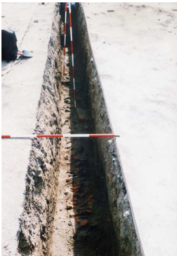
Slika 1. Zidana struktura (ostaci bedema?) u iskopu TKC-svjetlovodnog kabela u Ulici kralja Zvonimira 11 (snimio: M. Dizdar, 1998).
