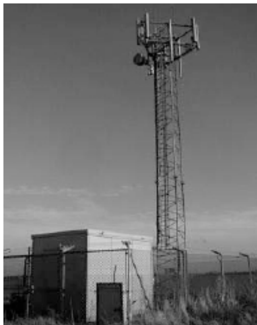
Slika 1. Bazna postaja montirana na samostojećem stupu
