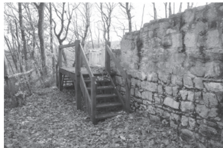
Sl. 8. Dio sjevernog zida i ulaz s novom drvenom konstrukcijom (foto: M. Šimek)
