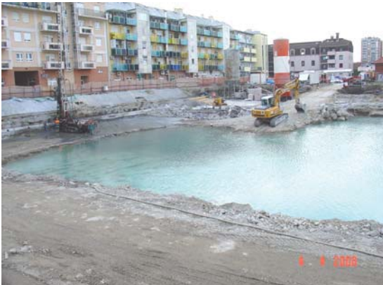
Slika 10. Potopljena jama prije sanacije stupnjaka
