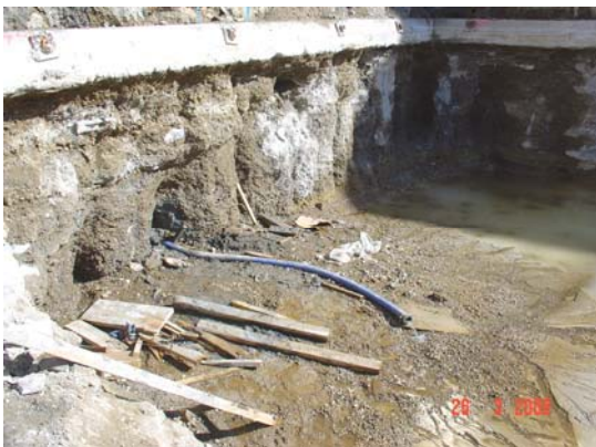
Slika 6. Mjesto prodora vode nakon hitne sanacije istoga
