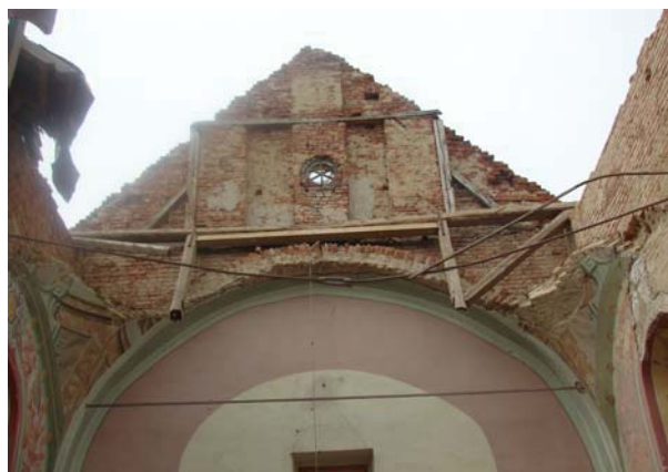
Slika 10. Unutrašnjost crkve bez svoda svetišta i krovišta, dok zabatni zid stoji slobodno
