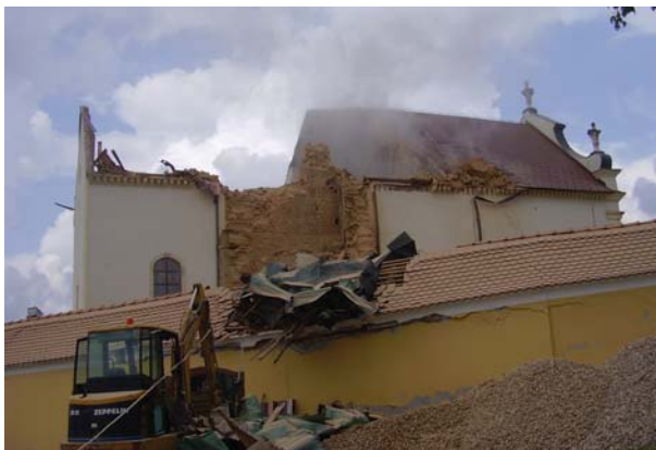
Slika 8. Urušena crkva bez tornja i dijela krovišta
