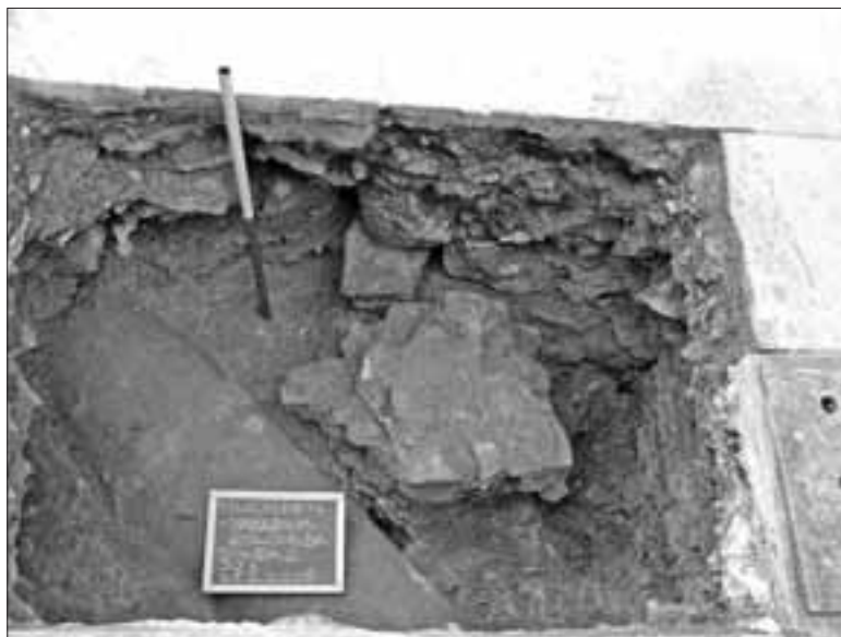
Slika 6. Oštećeni zid i kanalizacijska cijev unutar sonde
