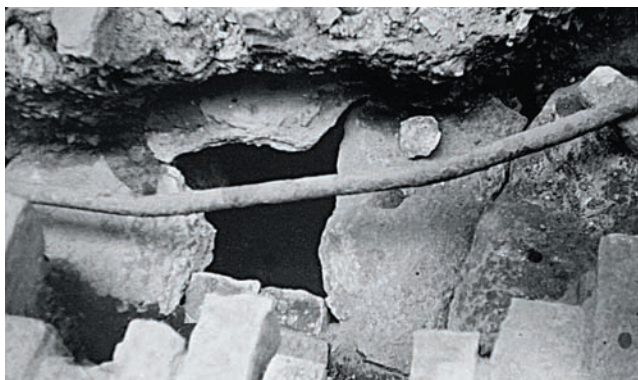
Sl. 5d U krupnom planu pogled na registrirano antičko popločenje i oštećenje u vidu veće rupe na dijelu antičkog popločenja i svodu antičke kanalizacije u Usponu Frana Glavinića oko kućnog broja 1 - 2, tijekom istraživanja 1975. - 76. godine (fotoarhiva Arheološkog muzeja Istre)
