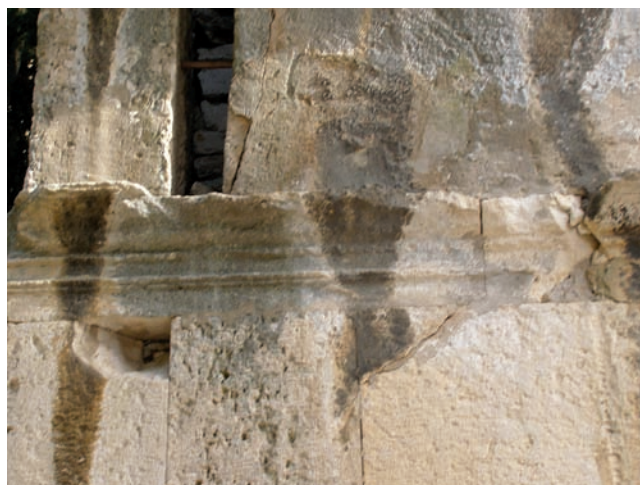
Sl. 12 Primjer nedostajućih dijelova profilacije i ugaonog dijela kamenog bloka Fig. 12 An example of missing parts in the form of decorative sections with a steplike profile, and a corner section of a stone block.
