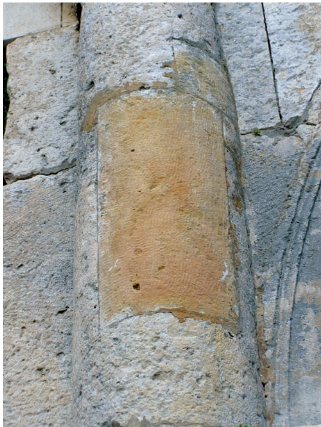
Sl. 5 Primjer mrlje na mjestu s kojeg je odstranjen katranski premaz; lijevi polustup istočnog pogleda
