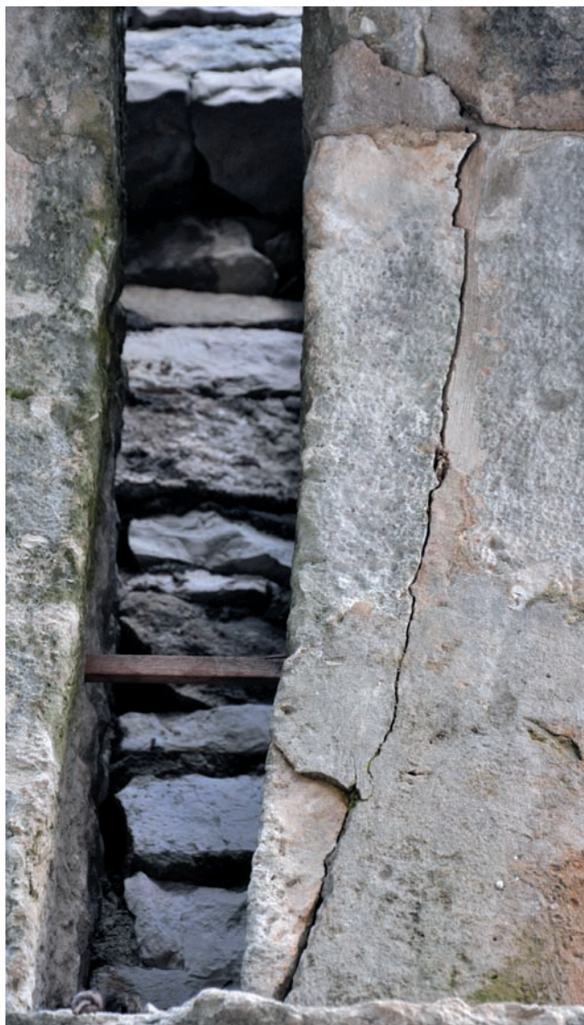
Sl. 13 Primjer pukotine Fig. 13 An example of a crevice.
