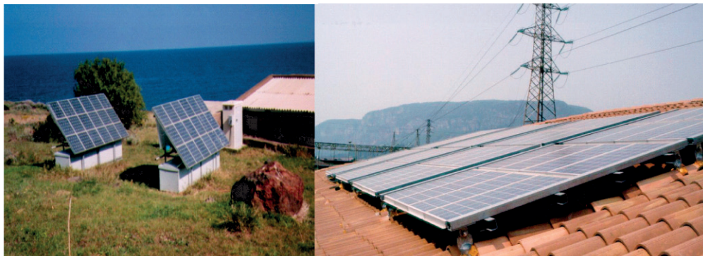
Slika 5. Solarne elektrane manje snage, samostojeća i smještena na krovu
