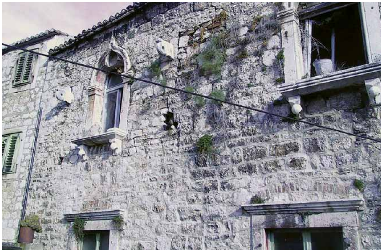
23 Zapadno pročelje kuće prije sanacije, (fototeka Konzervatorskog odjela u Splitu, 1993.)
