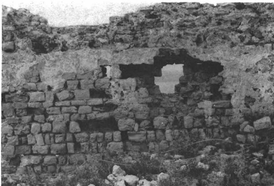
Sl. 4. Rt Ljubljana, ruševine crkve, sjeverni zid s vidljivim tragovima svoda i žbuke
