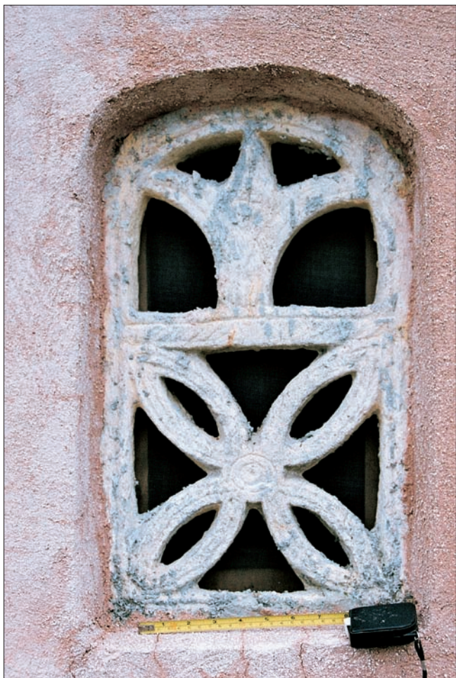
Sl. 9. Crkva Sv. Pavla, Palje Brdo, tranzena- stanje nakon “sanacije” (foto. Z. Žeravica)
