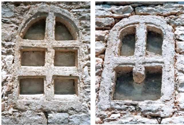
25. Prozori na južnom pročelju crkve sv. Flora u Pomeru (izvor: TERRIER, J. - JURKOVIĆ, M. - MATEJČIĆ, I., 2008., 243) Windows in the south wall of the church of St Florus at Pomer
