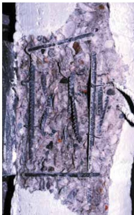
Slika 3. Bočni prikaz oštećenog čvora vanjske grede i stupa jer nema posmične armature
