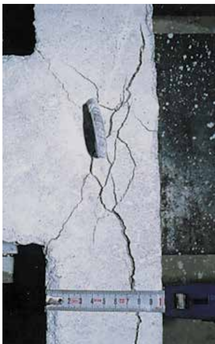
Slika 2. Tlocrtni prikaz štete na čvoru vanjske grede i stupa bez posmične armature
