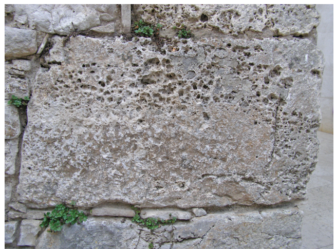
Sl. 10 Kameni blok zahvaćen alveolizacijom Fig. 10 A block of stone beset with alveolization.
