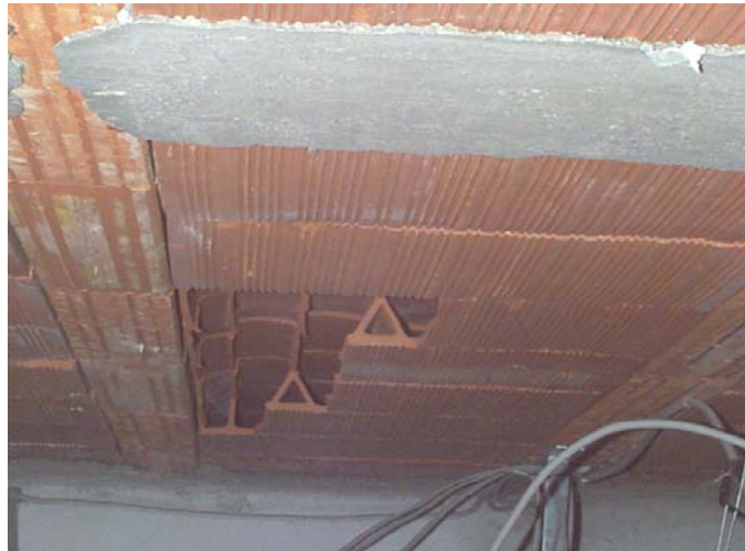
Slika 1 - Tipično oštećenje na stropu
