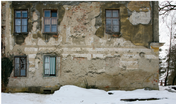
12. Dvorac Jakovlje, sjeverno pročelje središnjeg krila, tragovi barokne žbuke i arhitektonskih dekorativnih elemenata (snimio Z. Bogdanović)
