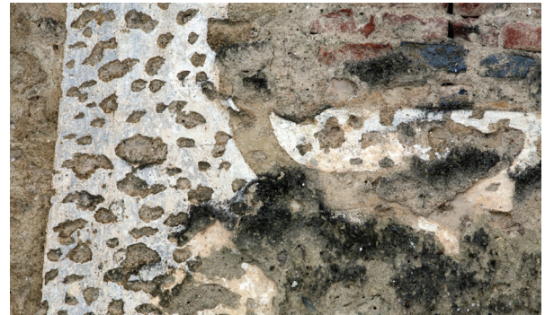
13. Dvorac Jakovlje, sjeverno pročelje središnjeg krila, detalj barokne arhitektonske plastike (snimio Z. Bogdanović)
