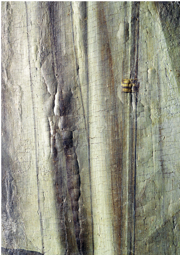
12. Detalj prije restauratorskih radova 1999. - 2001. godine koji dokumentira nova odignuća slikanog sloja (fototeka HRZ-a, snimio V. Barac).
