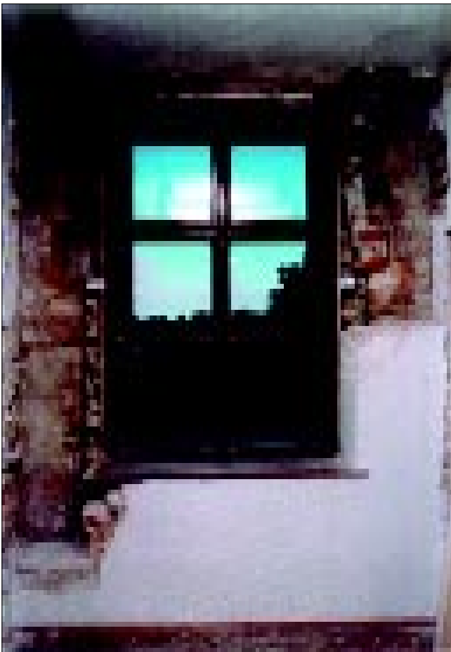
Sl. 15. Tragovi čeških prozora na II. katu palače Odescalchi uz jugoistočni ugao (snimka D. Ivić, Hrvatski restauratorski zavod)
