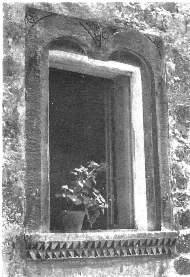
Sl. 51. Oštećeni dvojni prozor u Trogiru
