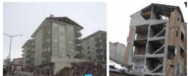
Slika 18. Oštećenja zabatnih zidova na zgradama
