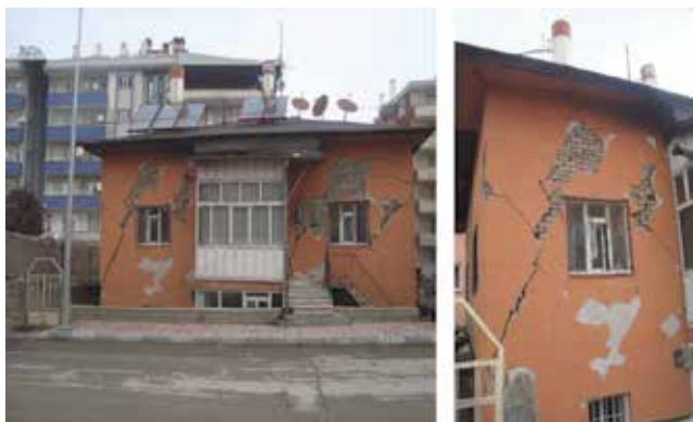
Slika 20. Karakteristična posmična oštećenja na konstrukcijskim zidovima zidanih zgrada u Vanu
