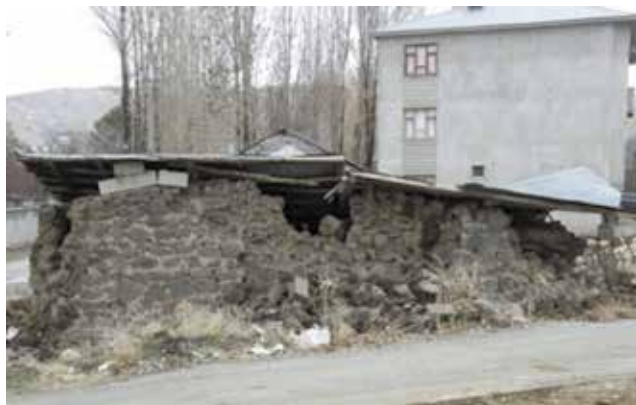
Slika 22. Urušavanje zidane zgrade u Ercišu zbog nedovoljne povezanosti zidova i krova te nedostatka žbuke
