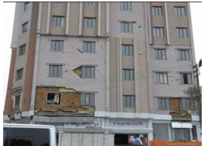
Slika 17. Dijagonalna oštećenja na dvostrukim zidovima ispunje u Vanu
