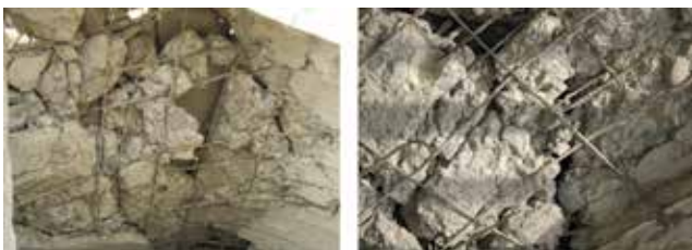
Slika 26. Slaba povezanost cementa i agregata
