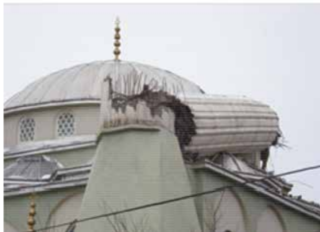
Slika 23. Dva minareta džamije u Ercišu: djelomično oštećeni i posve srušeni
