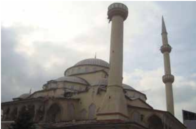
Slika 24. Neoštećeni i oštećeni minaret džamije u Vanu
