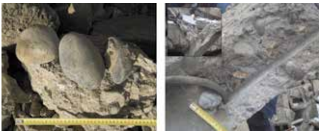
Slika 25. Neodgovarajući agregati u građevini od armiranog betona
