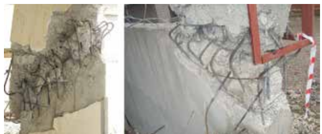
Slika 30. Šteta uzrokovana posmikom i izbočivanje uzdužne armature zbog neodgovarajućeg razmaka između poprečnih šipki
