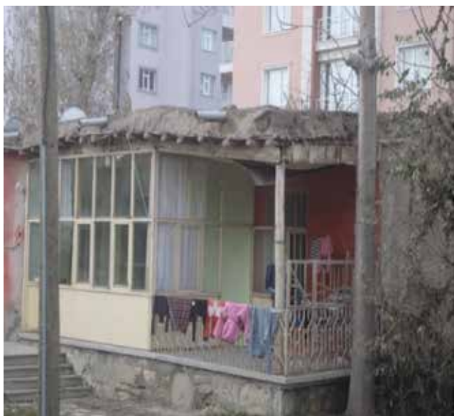
Slika 21. Pretjerana zemljana ispuna na krovu zidane zgrade
