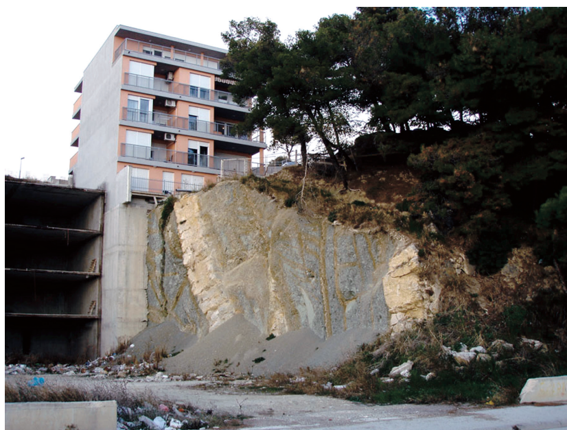
Slika 7. Trošenje lapora na kosini koja nije zaštićena od utjecaja atmosferilija (lokalitet Žnjan, Split; foto Aleksandar Toševski)
