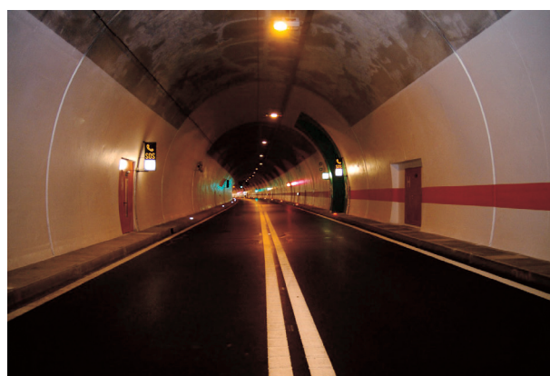
Figure 3. Sv. Tri Kralja Tunnel view on traffic tunnel tube Slika 3. Pogled na prometnu tunelsku cijev tunela Sv. Tri Kralja
