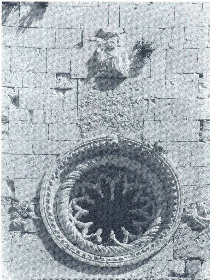
Rozeta sa simboličnim predočenjem Uznesenja Gospe, otučeni reljef sv. Marka i oštećeni Stvoritelja
