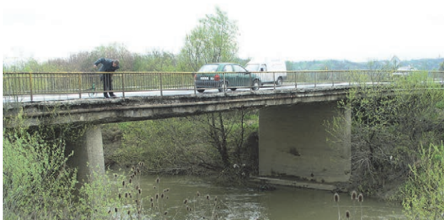
Slika 1. Most pod upravom Hrvatskih cesta prije sanacije 2012. godine – karakteristična oštećenja vijenca i rasponskog sklopa
