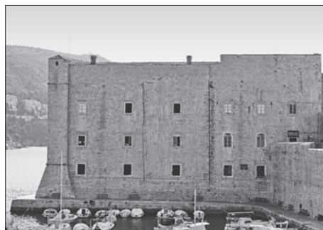
SL. 7. OSTATAK OTKLESANOG VIJENCA NA ISTOČNOM PROČELJU FIG. 7. REMAINS OF THE CORNICE ON THE EAST-FACING FACADE
