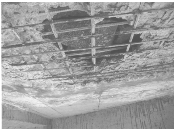
Slika 1. Primjer kolničke ploče "provaljene" već nakon dvadesetak godina uporabe
