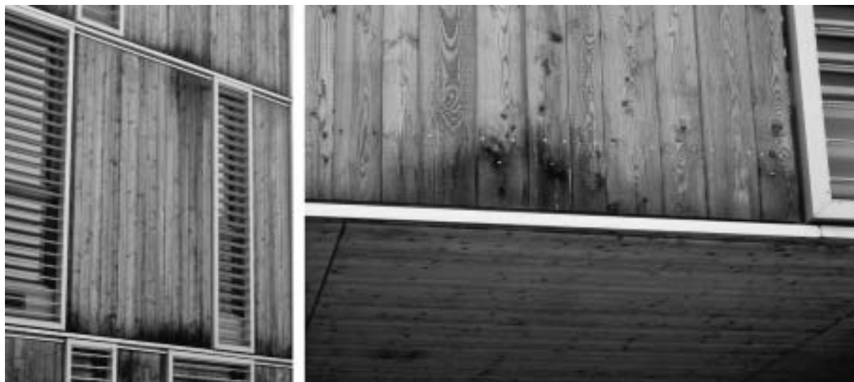
Slika 3. Oštećeni dijelovi pročelja
