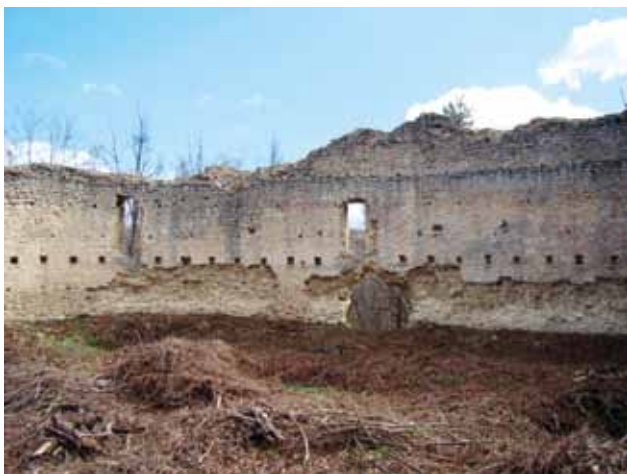
36 Degradacija prizemne zone istočnoga obodnog zida utvrde, ljudski faktor, (foto: R. Ivanušec)
