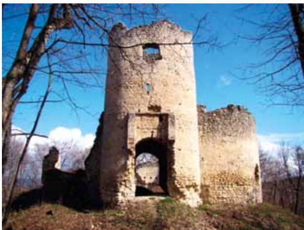
34 Zatečeno stanje ulazne kule prije zaštitnih radova – oštećenja zida u prizemnoj zoni kule (foto: R. Ivanušec)
