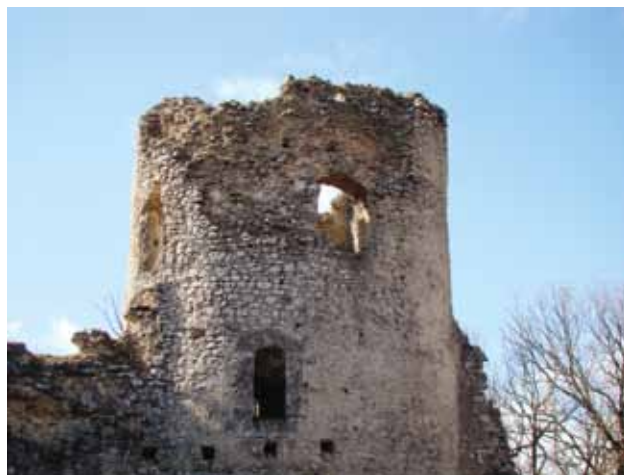
35 Oštećenje gornje zone zida ulazne kule zbog djelovanja atmosferilija (foto: R. Ivanušec)
