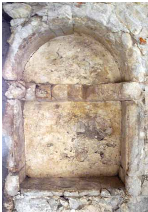
18 Pilo u kući Rosso, Burak, k.č.zgr. 248 k.o. Hvar, stanje tijekom istražnih radova (foto: A. Gamulin)
