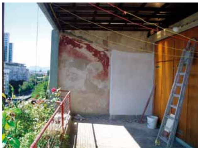
19 Vukovarska 35-35 a, balkon na VII. katu, prije obnove (foto: J. Šćavničar- Ivković)
