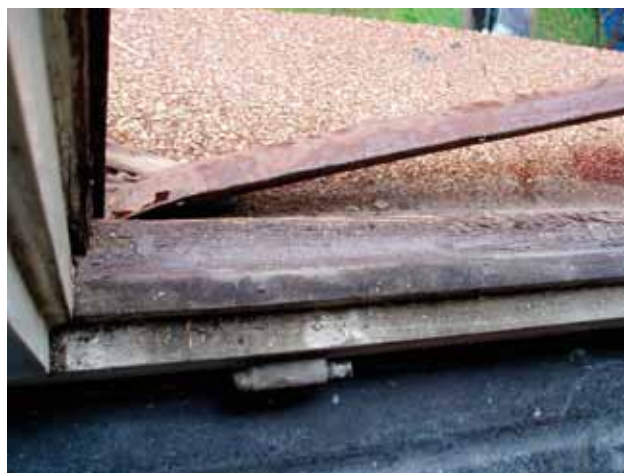
20 Vukovarska 35-35 a, detalj prozora stana prije obnove (foto: J. Šćavničar Ivković)
