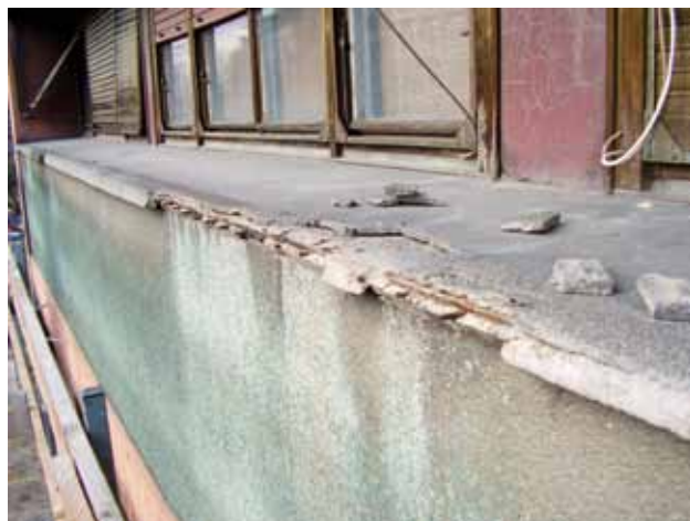
18 Vukovarska 35-35 a, detalj pročelja prije obnove, oštećenje kulira (fototeka GSKG)
