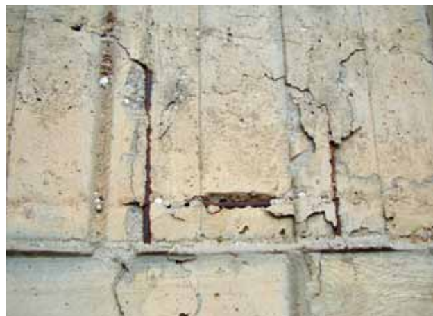
13 Vukovarska 35-35 a, detalj pročelja prije obnove, oštećenje betona (fototeka GSKG-a)
