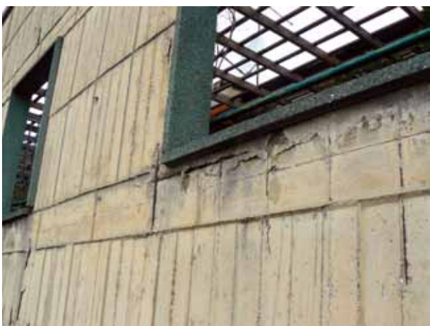
14 Vukovarska 35-35 a, detalj pročelja prije obnove, VII. kat (fototeka GSKG-a)
