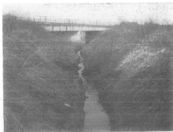
Ulaz kolektora INA—Rafinerija—Zagreb u glavni odvodni kanal grada na žitnjaku
