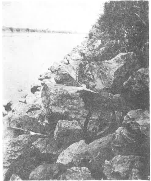
Desna obala Save kod Termotoplane Zagreb, označeni tragovi katrana (1976.)
