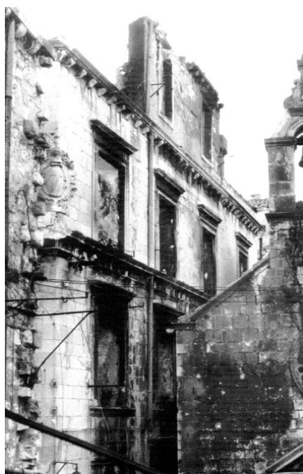
Slika 2. Sjeverno i zapadno opožareno pročelje palače; pogled na opožareno predvorje
