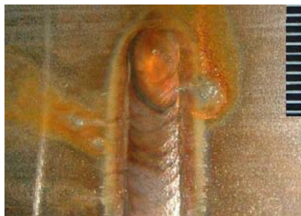
Figure 4. Results of field test of resistance towards microbiologically influenced corrosion on a welded joint Slika 4. Rezultat terenskog korozijskog ispitivanja otpornosti na mikrobiološki poticanu koroziju na zavarenom spoju
