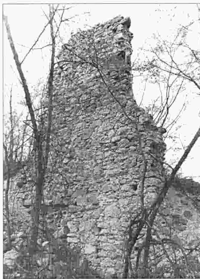
Sl. 30. Južni obrambeni zid (o) gradske jezgre. Snimio Drago Miletić u travnju 1992.
