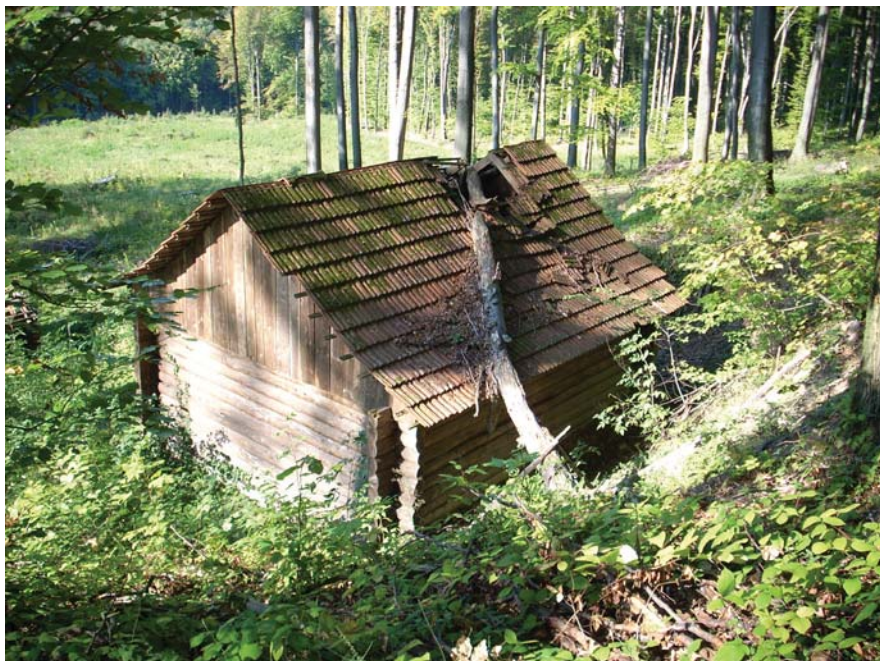
Sl. 2: Pogled na oštećeno krovšte gornje barake
