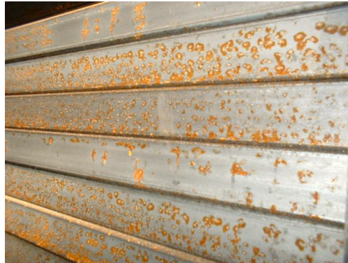
Slika 2: Korodirane precizne šavne cijevi 25 mm × 25 mm × 2 mm
