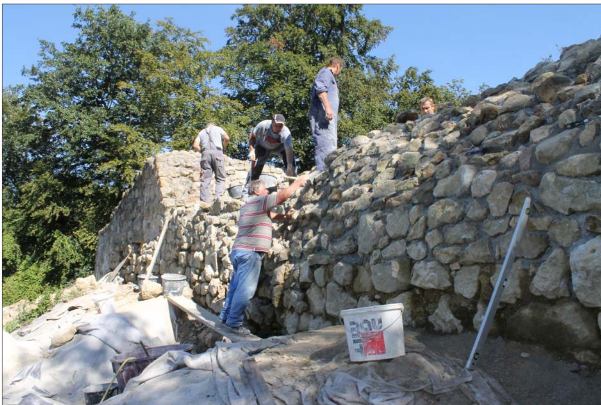
Sl. 4 Zidarski radovi, pogled na vanjsko lice zida SJ 061 od jugozapada (snimila: T. Tkalčec)
