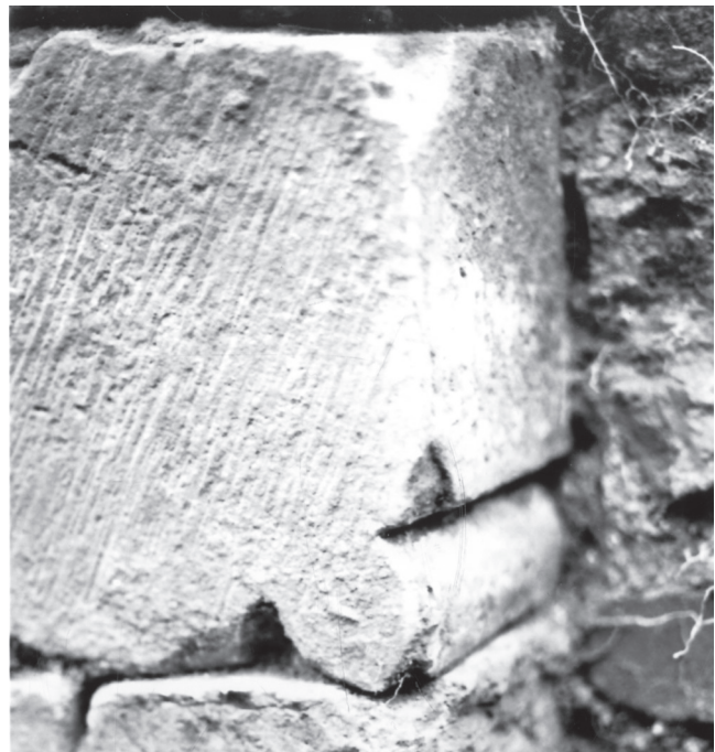
Sl. 9 Spolij u temeljima južnog krila, vjerojatno dio konstrukcije kao i na sl. 8 (foto: M. Visin, 1999.)
