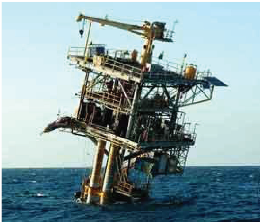
Slika 2. Oštećenje eksploatacijske platforme uslijed udara plovnog objekta [10]
