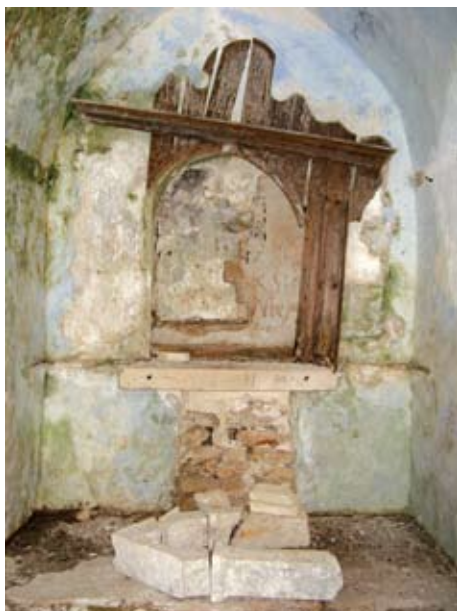
Unutrašnjost crkve s devastiranim oltarom i slomljenom preslicom
