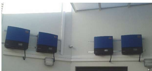
Slika 3. Prikaz smještaja pretvarača na objektu
