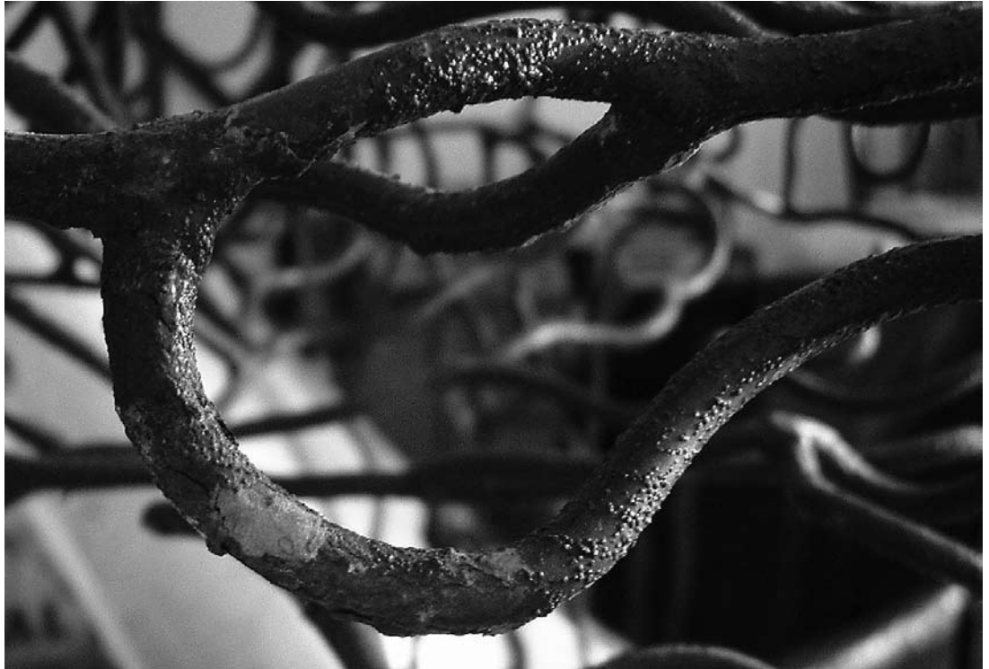
sl. 2. Majkus, Siniša: Stolica Newton – Wilson Detalj oštećenja: na mjestu gubitka završnog premaza vidi se uznapredovala korozija
